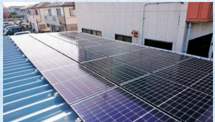
店舗の屋根には、9kwの太陽光発電を設置し、余剰電力は売電しています。
