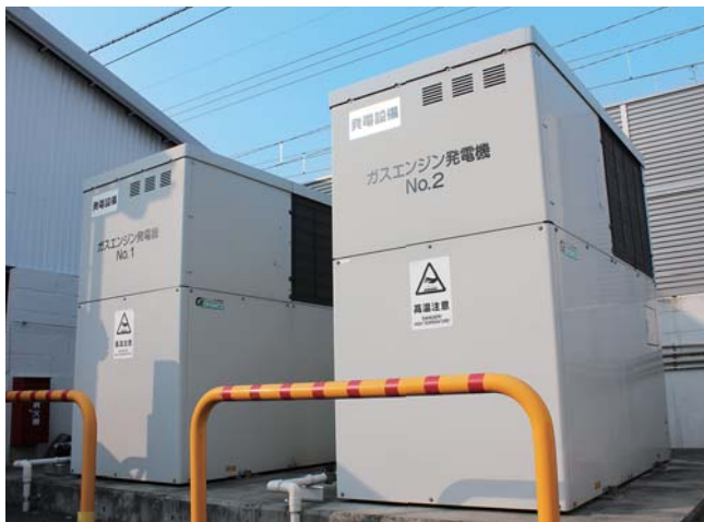
ガスエンジン
