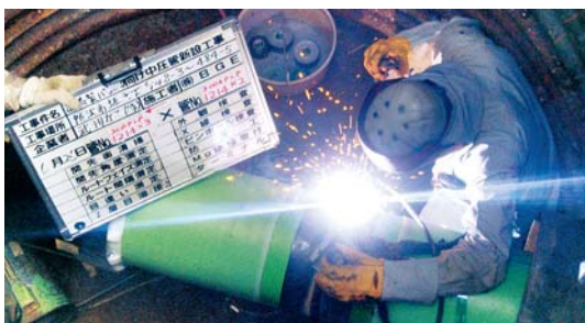
中圧ガス管 溶接接合鋼管
