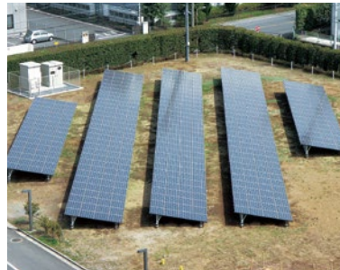
坂戸事務所に設置した太陽光発電
